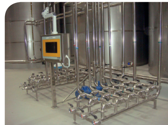
Instalación típica de bomba de aletas (serie BAL) en una almazara.
